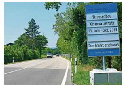
Die Knonauerstrasse in Steinhausen muss saniert werden. Kristina Gysi
